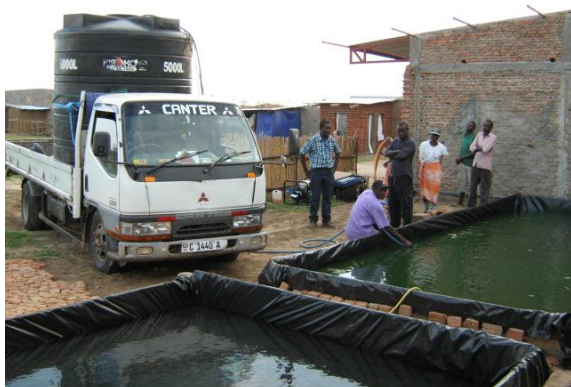
Bâtiment principal en cours de finition La spiruline arrive de l'ancienne installation pour être transférée à Gatumba dans les bassins provisoires
